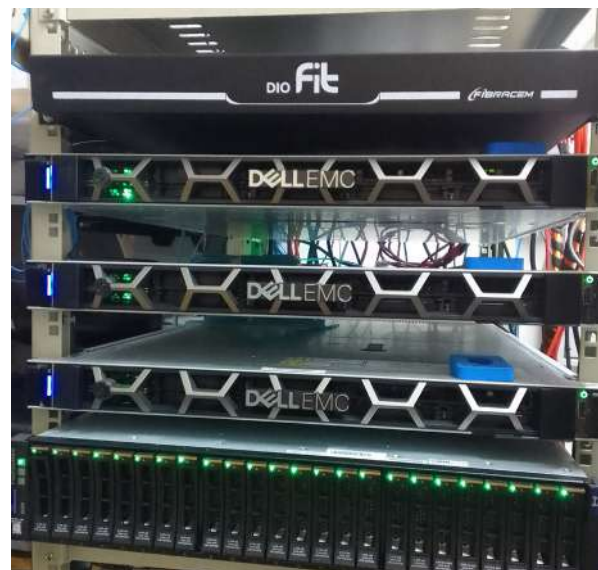
Os três servidores Dell e o Storage IBM.
